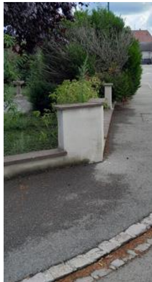
Dépassement de haie non conforme
